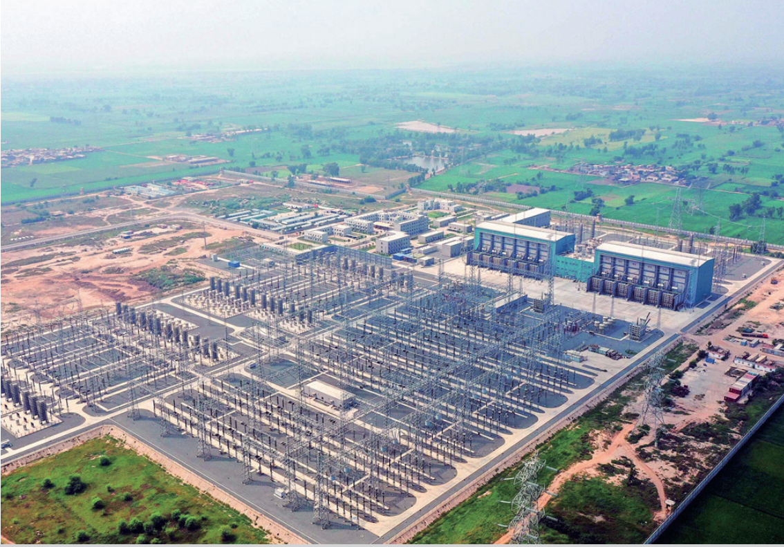
CPEC kapsamında Pakistan'ın doğusundaki Pencap Eyaleti'ndeki yüksek gerilim doğru akım iletim hattı projesinin Lahor Dönüştürücü İstasyonu (Fotoğraf: Xinhua, 2022).
